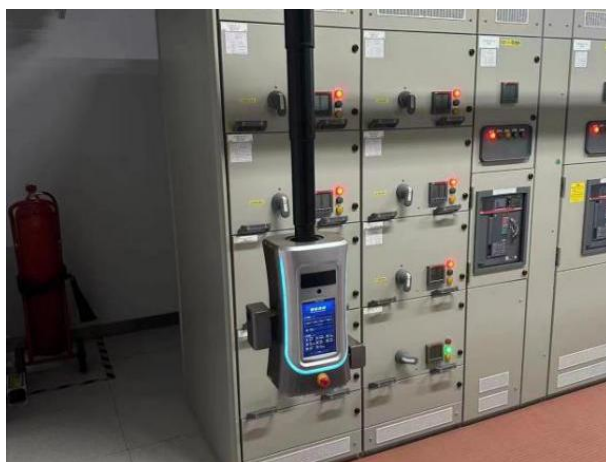
图 3: 海通证券张江数据中心智能巡检机器人
