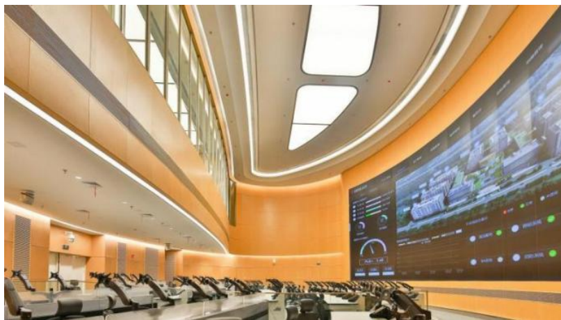
图 1：上交所金桥数据中心 D3 机房楼基础设施管理（DCIM）平台
