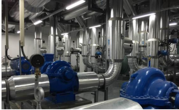
图 3: 绍兴轻纺城数据中心（中楼南楼）冷冻站内景
