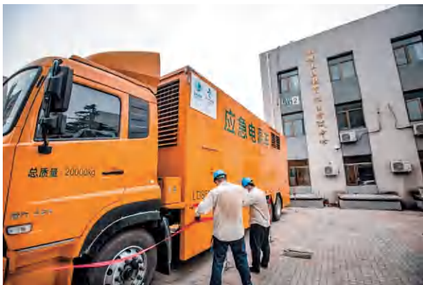
6月，石景山供电公司发电车运行人员在区考试中心开展发电车接入工作
