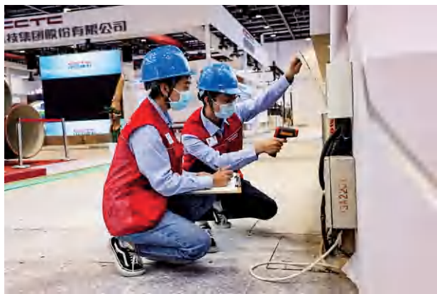
8月，朝阳供电公司员工对国家会议中心服贸会相关电力设施进行测温、巡视工作
