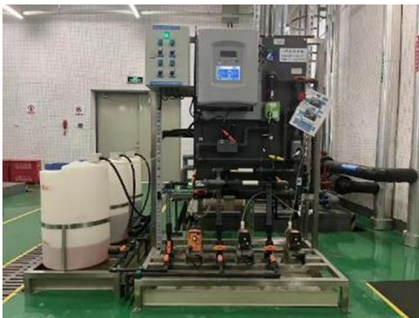
中国建设银行武汉南湖数据中心冷却水处理设备
